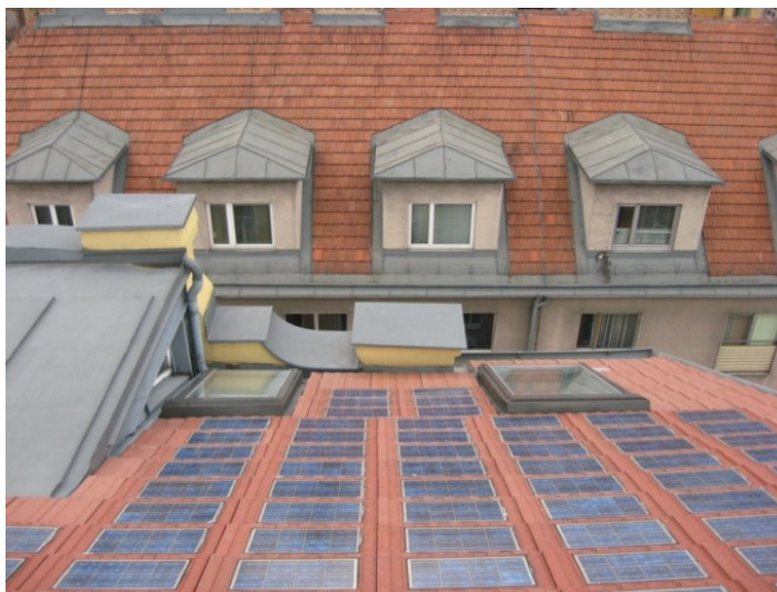
Фотогальваническая установка, встроенная в кирпичную крышу
