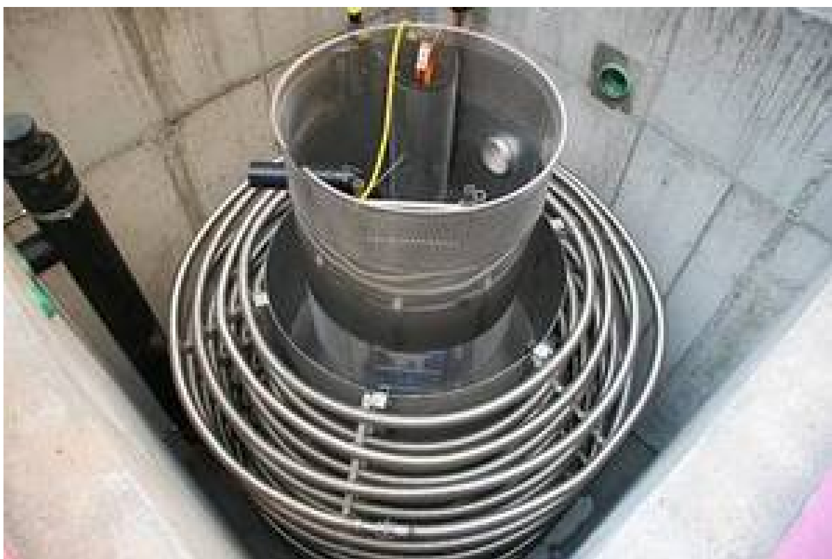
П.3. Вид на теплообменник-утилизатор перед обвязкой
