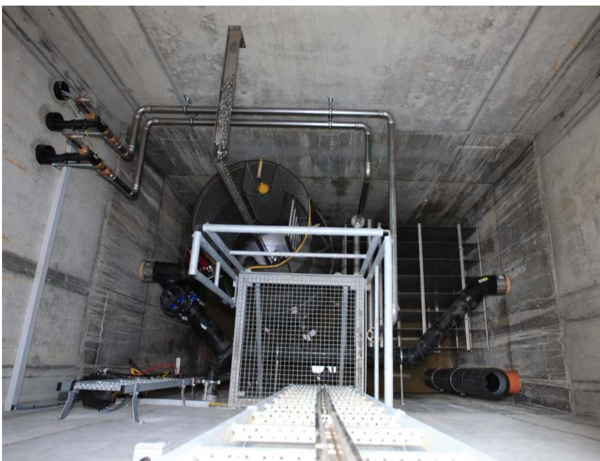
Рис. П.4. Вид на блок утилизации теплоты городских сточных вод
