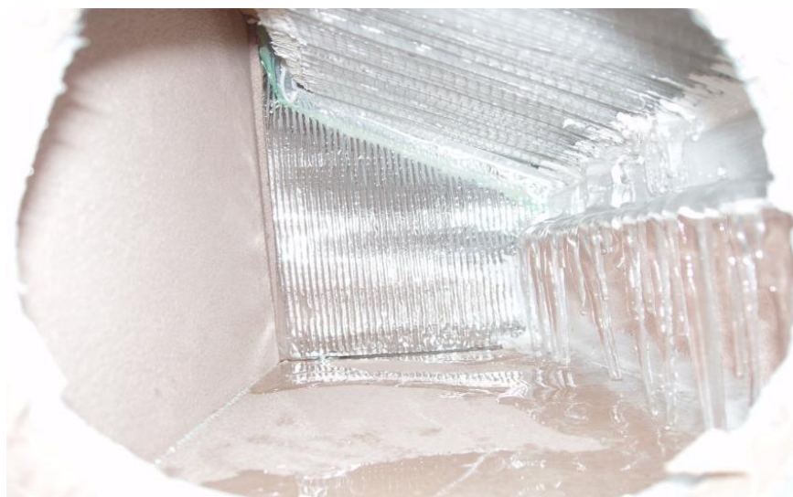
Рисунок 1 – Замерзший конденсат в камере удаляемого воздуха рекуперативного теплообменника
